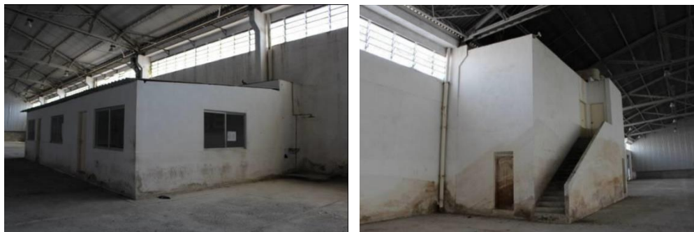
Figura 3 – Escritório e instalação de apoio operacional, internos ao Armazém 06.
