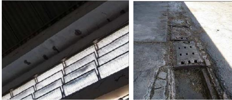
Figura 10 – Vitrais internos e drenagem externa ao Armazém 06.
